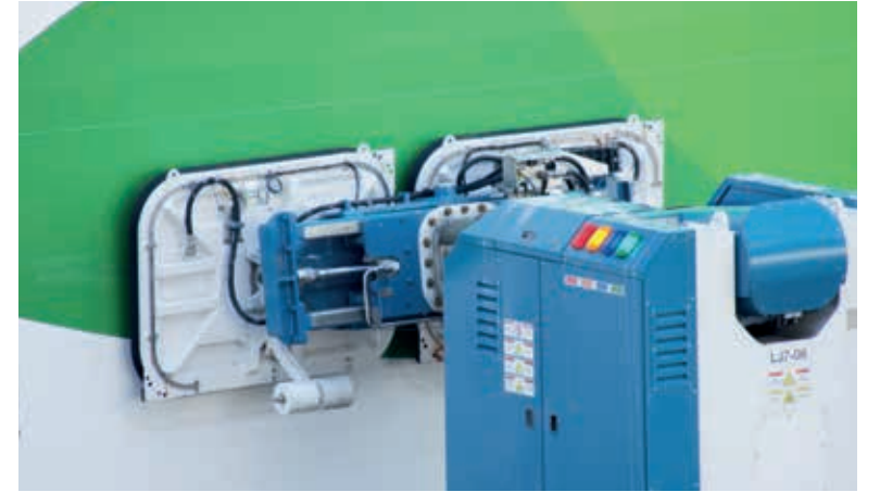
Automaattinen laivojenkiinnitysjärjestelmä vähentää pakokaasupäästöjä. Det automatiska systemet för förtöjning av fartyg vid kajen minskar avgasutsläpp.
